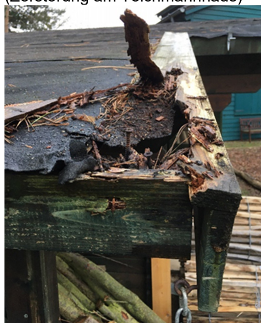
(starke Beschädigung am Dach)
